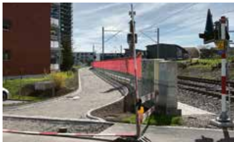
Neuer Fuss- und Veloweg entlang der Bahnlinie im Bau: Höchst komplexe Aufgabe beim Bahnhof, problemlos im Abschnitt Grünastrasse–Bächtelenpark Bilder pp
