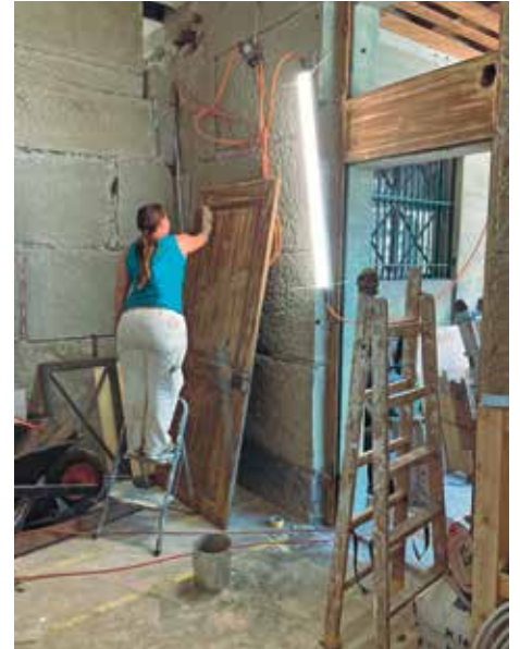
Kutschnerie EG: Letzte Sanierungsarbeiten, wo einst Kutschen, Pferde und Bedienstete untergebracht waren.
